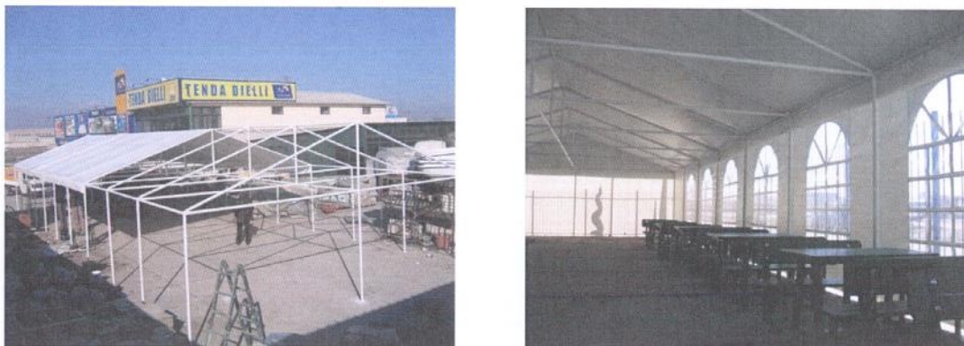
Fig. 1. Kapanoni i përfunduar (1,2 – lart), si dhe montimi i mbulesës/membranës veshëse. Foto të objektit të ndërtuar nga ‘Tenda Dielli’ Shpk, Autostrada Tiranë-Durrës, km 12.
